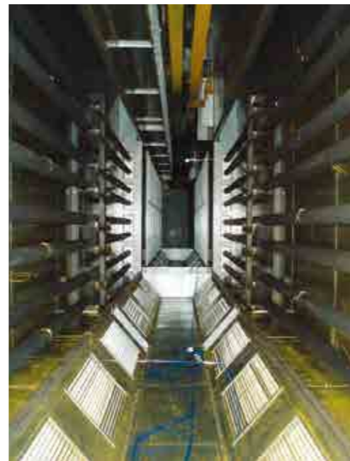
建機部品 連続塗装乾燥炉 内部 遠赤バーナー BT-33NH×16 基 最大消費量：LPG 38.4kg/h、13A 42.2m³/h
