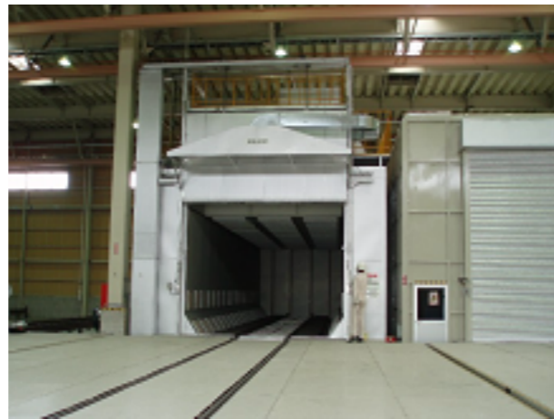
大型車両用 塗装乾燥炉
